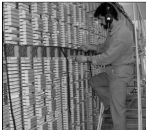
اتصال مراکز مخابراتی، کابوهای نوری، کابل‌ها و تلفن‌های همگانی و... به یک مرکز مانیتورینگ در نظر گرفته شده است تا از این طریق، تا حد امکان از سرقت و تخریب تجهیزات مخابراتی
